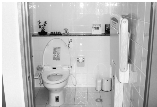
ゆったりと清潔感溢れる1階女性用トイレ。車いすで利用でき、おむつ交換用ベビーベッドも完備
