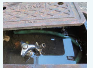
水没した埋込型散水栓
